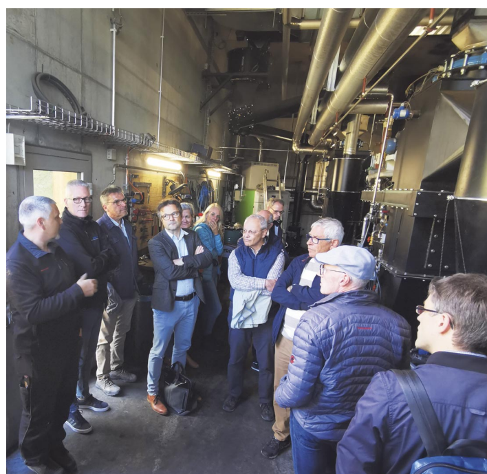
Im Rahmen des 22. Erfahrungsaustausches führte eine Exkursion zum Holzheizwerk Malbun. Bilder: Lenum AG
