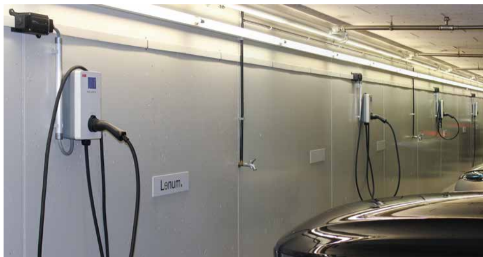
Mit der richtigen Grundinstallation sind neue Ladestationen ganz einfach nachrüstbar
