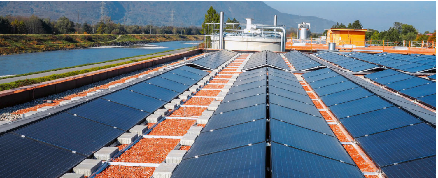
Die Photovoltaikanlage im Gewerbegebiet Gamprin mit einer Leistung von 354 kWp.
